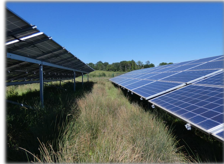
Végétation humide colonisant un parc photovoltaïque en exploitation (Photo ECTARE – Hauterive (03))
